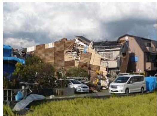
■ 写真2 飛来物による建物の損傷
